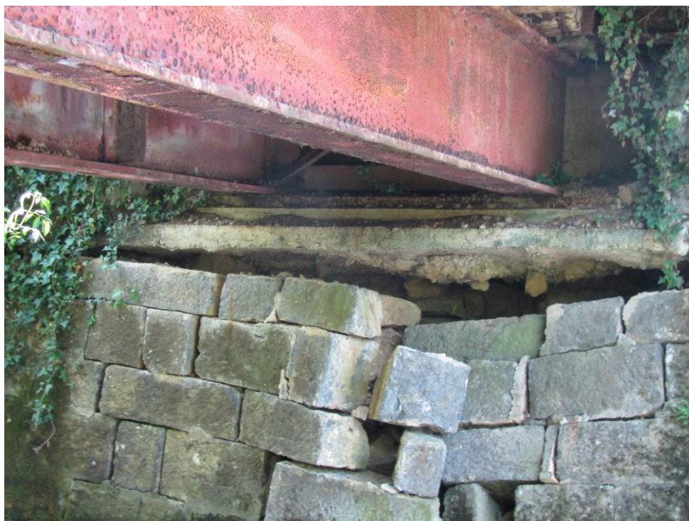
Slika 10: Opornik – levi breg; vidna predvidoma šibko-armirana ležiščna plošča in razpadanje opornika v spodnjem delu.
