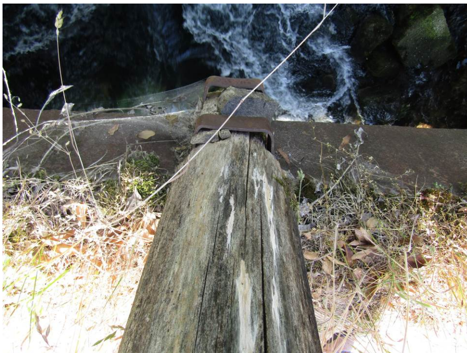
Slika 4: Sidranje mostne ograje, deloma izpadle lesene zagozde.
