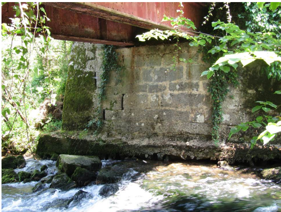
Slika 6: Opornik – desni breg; strižna razpoka zaradi posedanja dol-vodnega dela opornika.
