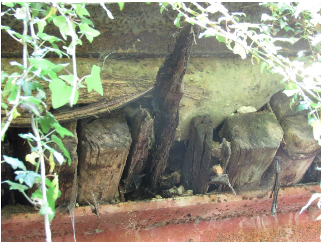
Slika 16: Propadli leseni prečnik na nesti naleganja na primarni nosileci, geotekstil za stabilizacijo gramoznega nasutja voziščne konstrukcije.
