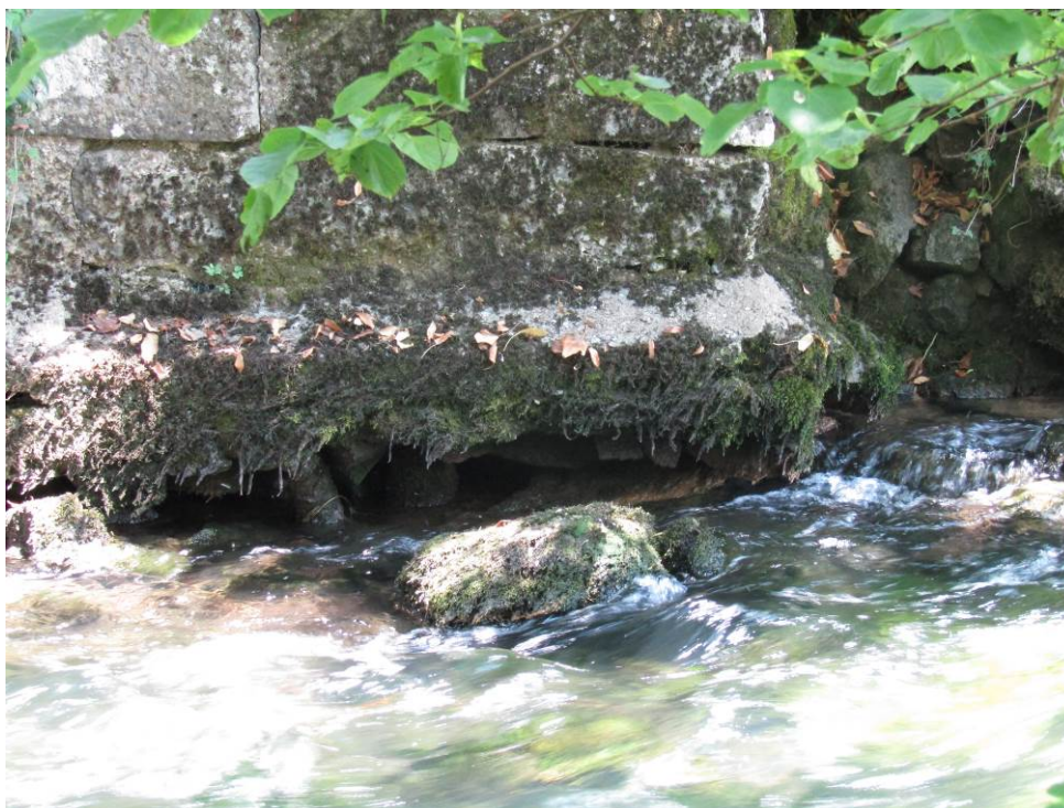
Slika 7: Opornik – desni breg; erozijska zajeda pod opornikom.
