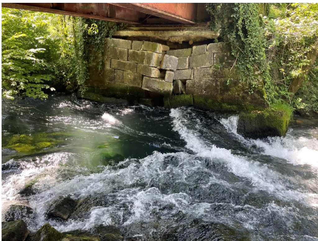
Slika 8: Opornik – levi breg; porušeni kamniti gradniki opornika zaradi erozijskega izpodjedanja, struga vodotoka z višinsko stopnjo.
