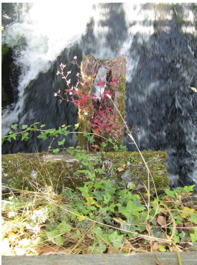
Slika 5: Podaljšani leseni vmesni prečnik; luknja na zaključku prečnika nastala zaradi intenzivnega propadanja.
