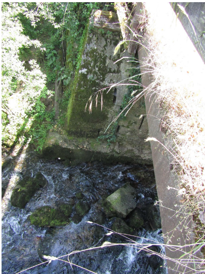
Slika 7a: Opornik – desni breg; odprte fuge med kamnitimi gradniki.
