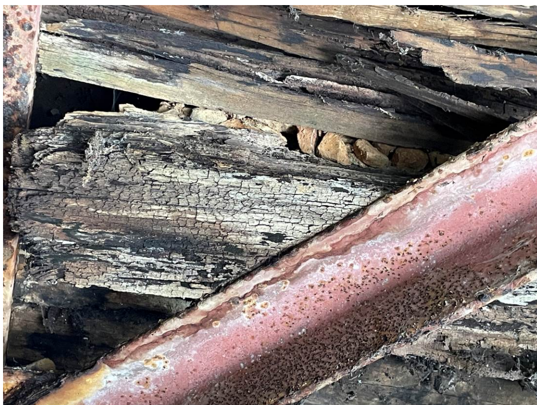
Slika 18: Popolnoma propadel in dislociran leseni prečnik na mestu naleganja na primarni nosilec, vidno izpadanje gramozne voziščne konstrukcije.
